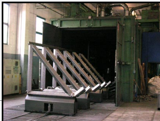
KOMORA DO PIASKOWANIA STALOWYCH ELEMENTÓW MASZYN
